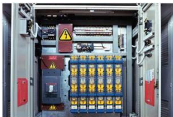
شکل (۷): یک نمونه از شکل واقعی تابلوی فشار ضعیف
