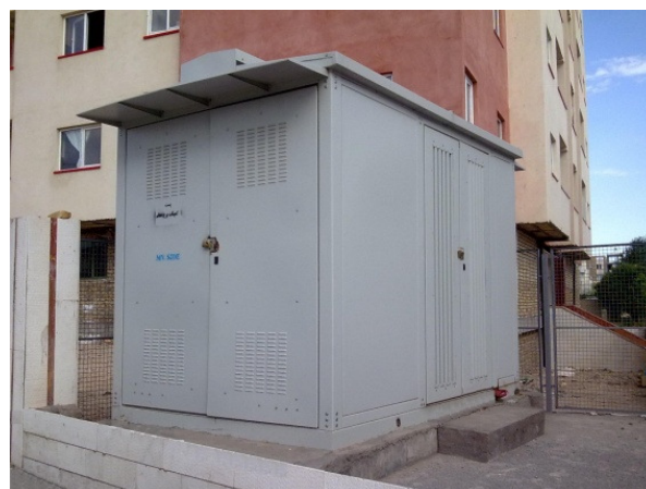
(الف): یک نمونه پست پیش‌ساخته کمپکت فلزی
